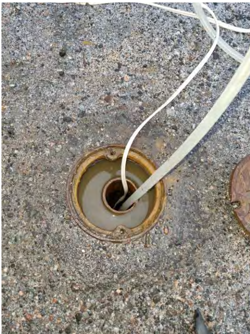
Figur 5 Gv-rör 2108 vid omsättning, Foto från Sweco.
