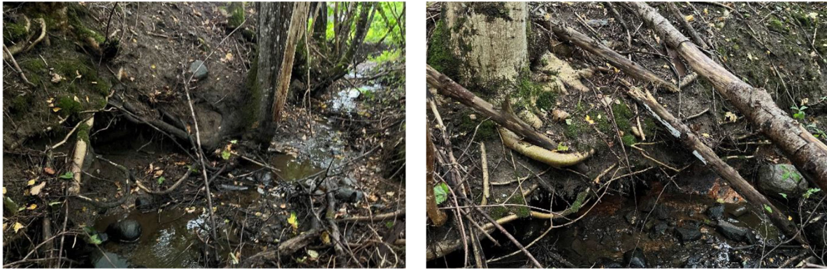
Figur 25. Exempelbilder på erosionsskador uppkomna längs med bäckens västra sida nedströms.
