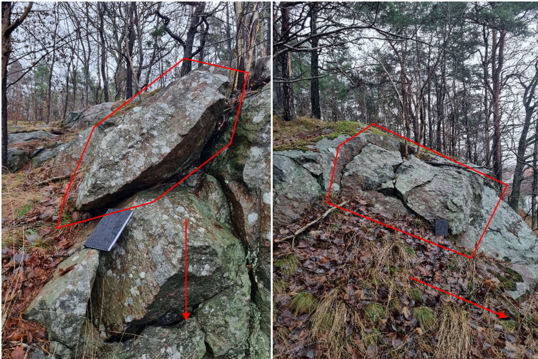
Figur 3. Bergslänt med risk för blockutfall i område 2. Vänster: fotat mot öst. Höger: fotat mot söder. Pilar visar riktning nedåt i slänten.
