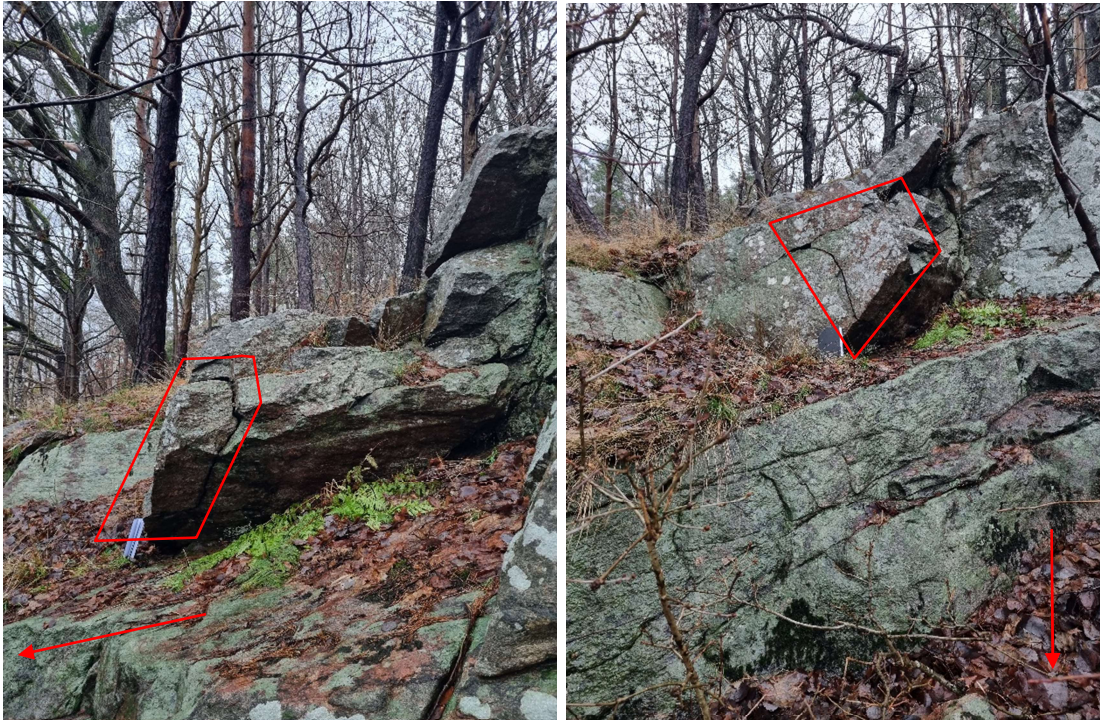
Figur 2. Bergslänt med risk för blockutfall i område 1. Vänster: fotat mot öst. Höger: fotat mot norr. Pil visar riktning nedåt i slänten.
