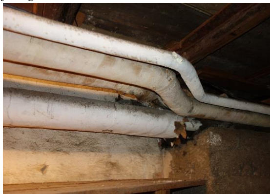
Figur 47. Förekommande rör med olika dimensioner och olika rörisoleringar.
