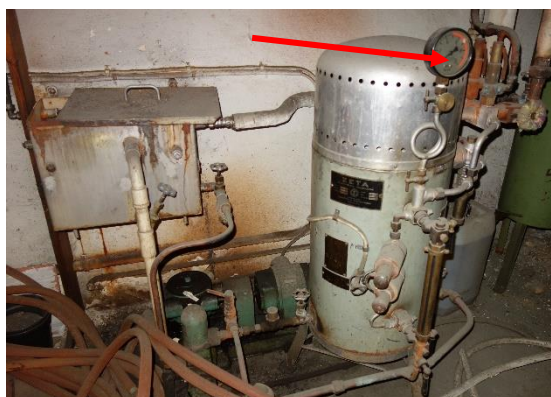
Figur 39. Elektrisk ångpanna från 1953 innehållande asbest, med kvicksilvergivare och tillhörande installationer.
