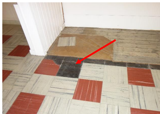
Figur 23. Svartlim med asbest på masonit i originaldelen på plan 2 (prov 13). Plattmattan innehåller inte asbest men går som asbestavfall tillsammans med masonitskivan.
