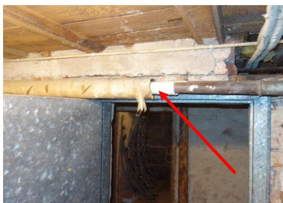
Figur 45. Exempel på rör med asbestpapp längs hela röret. Här är asbestpappen delvis frilagd.
