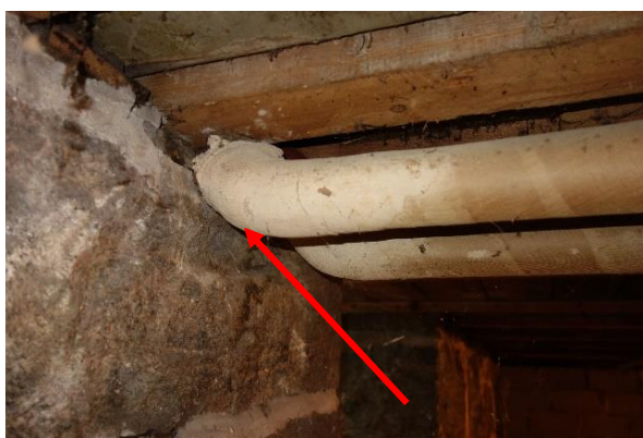
Figur 44. Exempel på rör med asbest i rörkrökar.
