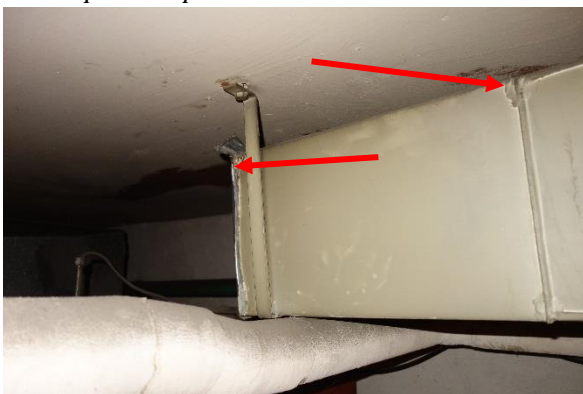
Figur 34. Prov 5 Grå hård tätningsmassa på ventilationskanal av plåt i källaren.
