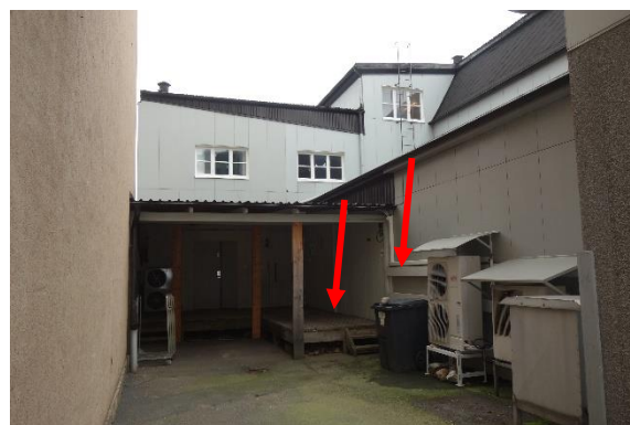
Figur 15. Golvkonstruktionen på lastbryggan är av koppartryckt virke, men inte stolpar och tak. Plankor på väggen är tryckimpregnerade med CCA.
