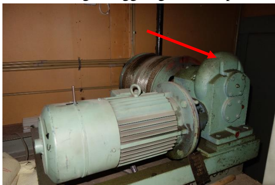
Figur 50. Äldre hissmaskin som misstänks innehålla PCB.
