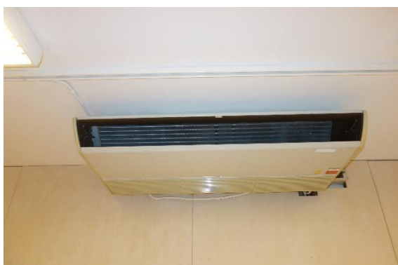
Figur 42. Exempel på invändig del av klimateanläggning.
