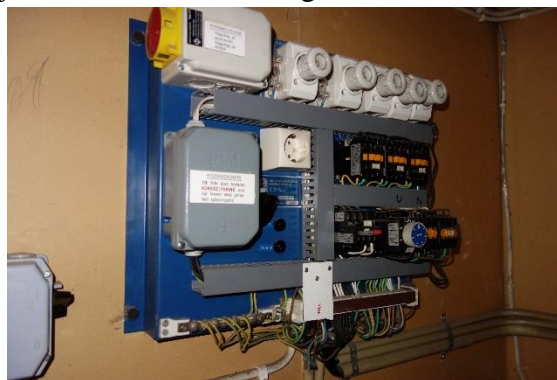
Figur 51. Styrcentral för hissmaskin.
