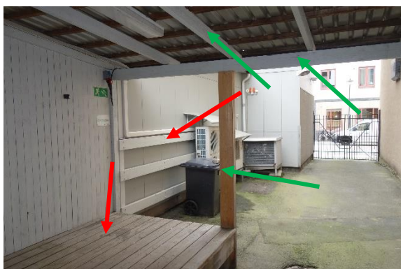
Figur 14. Golvkonstruktionen på lastbryggan är av koppartryckt virke, men inte stolpar och tak. Plankor på väggen är tryckimpregnerade med CCA.
