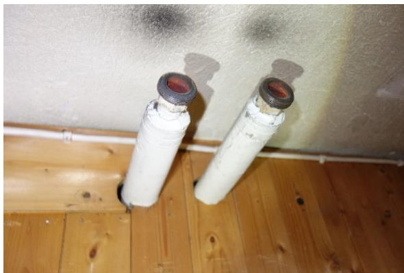
Figur 46. Exempel på rör med asbest i röravslut (och även i rörkrökar).
