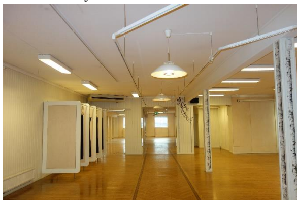
Figur 54. Exempel på förekommande armaturer.
