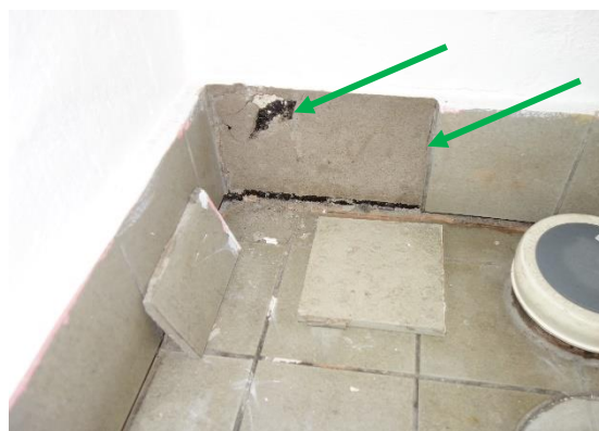
Figur 29. Prov 15 Klinkerfog, -bruk och svart fuktspärr (bitumen) innehåller inte asbest enligt analys.
