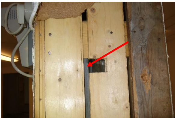
Figur 32. Eternitkanaler noterade i vertikalt schakt på vindsplan.
