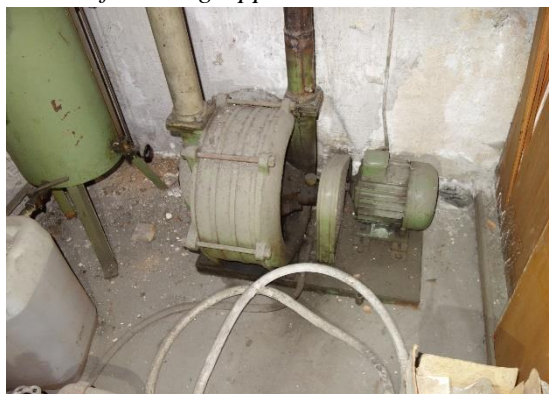
Figur 35. Frånluftsfläkt i källaren, ingen noterad asbest.
