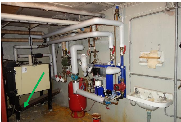
Figur 36. Nya installationer för fjärrvärme samt oljepanna från 1989. Flänspackning (prov 4) mellan panna/rökgaskanal innehåller ej asbest.
