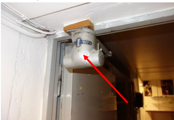
Figur 18. Exempel på förekommande äldre dörrstängare med PCB-olja.
