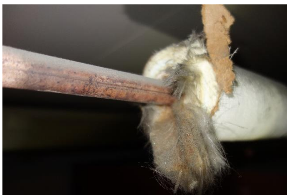
Figur 48. Exempel på rörisolering utan asbest.
