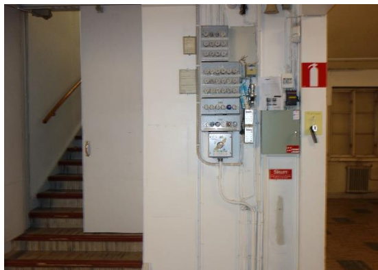
Figur 53. El-centraler och installationer för brand och larm.
