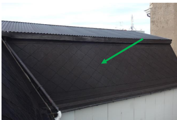
Figur 6. Brant takdel på originaldelen är belagd med rödmålade omlottliggande plåtskivor. Varken röd färg eller svart beläggning innehåller asbest (prov 9, grön pil). På den flacka delen ligger en TRP plåt.
