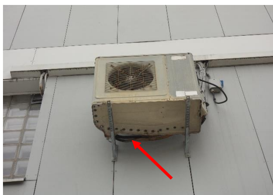
Figur 41. Exempel på klimateanläggning sittandes på väggen med svart cellgummiisolering på rör/slangar.
