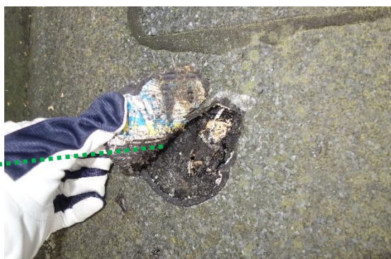
Figur 9. Prov 18 klister/äldre takpapp under den nya takpappen innehåller inte asbest enligt analys.
