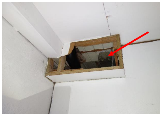
Figur 33. Liggande eternitkanal noterad i område för WC-grupp.
