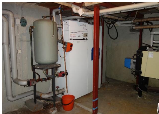
Figur 37. Expansionskärl och andra mindre installationer+ styrskåp.
