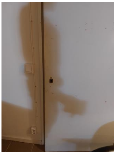
Bild 4, utrymningsbeslag på dörr i allrum till trapphus 2 saknar beslag. Dörr är oklassad samt otät.
