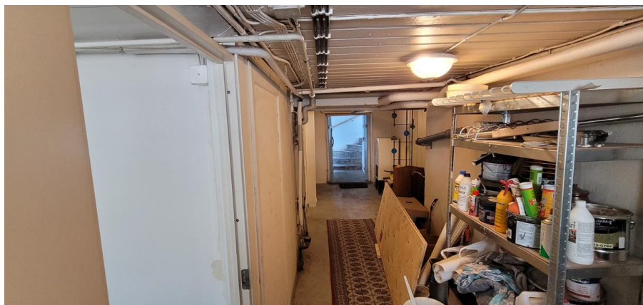
Bild 7. Tvättstuga till vänster, oklassad dörr samt otätt upptill. Trapphus 1 rakt fram. Målat trä i taket.
