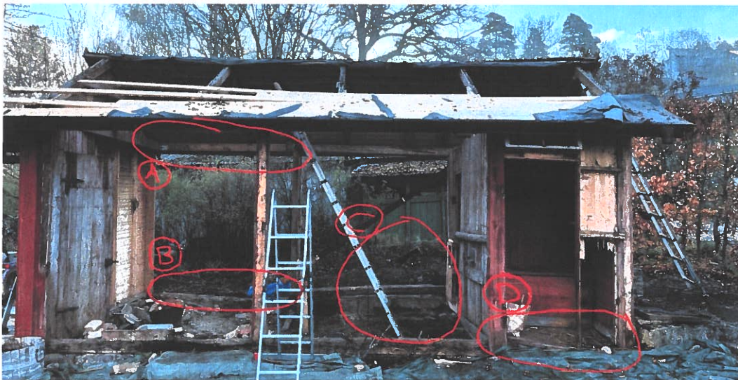
Figur 4: Golv och bjälklag har inte funnits på åtminstone 15 år i delen till vänster utan bortre vägg. Endast jordgolv invändigt.
