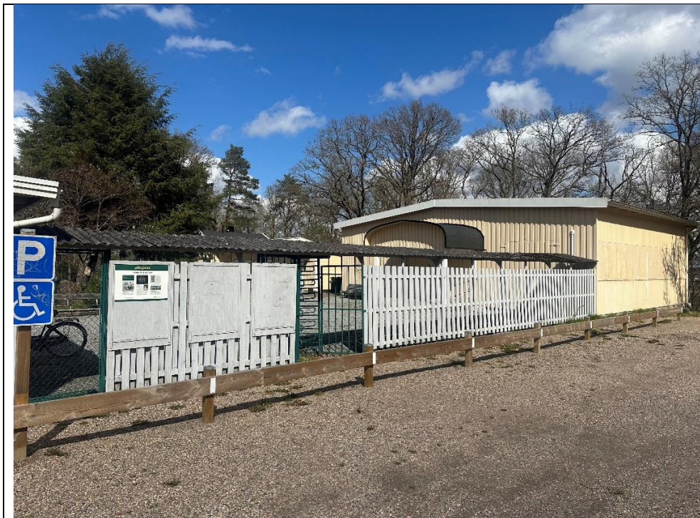
Bild 3: Staket inhängning med tak av eternit innehåller asbest.
