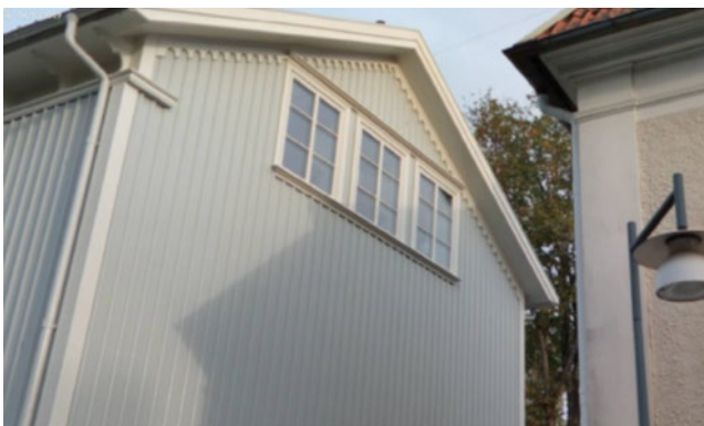
Östra fasaden 2019-10-04 Helt fönster med 6 lufter totalt.
