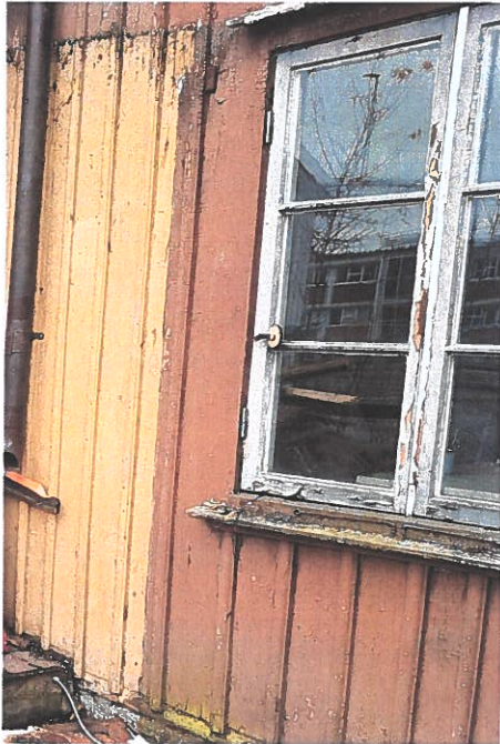
Gul kulör på ytterpanel som tidigare varit dold av byggnation
