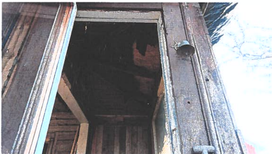
Verandan innan demontering. Reglarna med sina konsoler var tyvärr kraftigt rötangripna och fick därför endast tjänstgöra som mall för ny tillverkning
